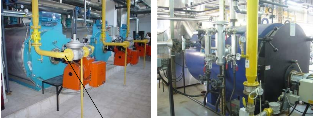
Brülör bağlantı hattı
