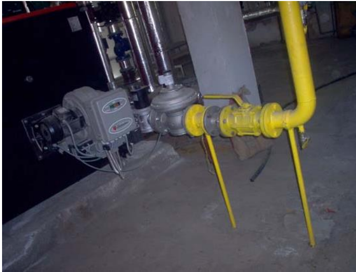
Resim 3.6: Kazan gaz besleme borularının desteklenmesi
