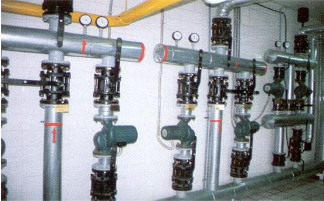
Resim 2.2: Dolařım pompaları baėlantısı
